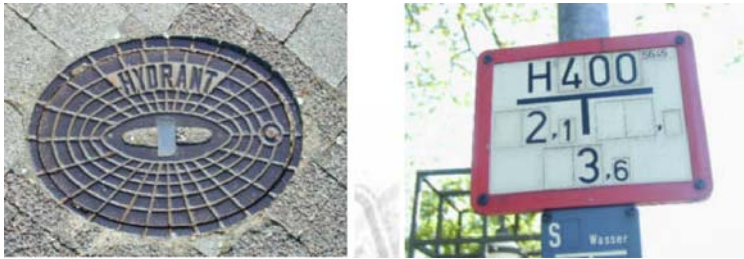
Abdeckung Unterflurhydrant und Hinweisschild
